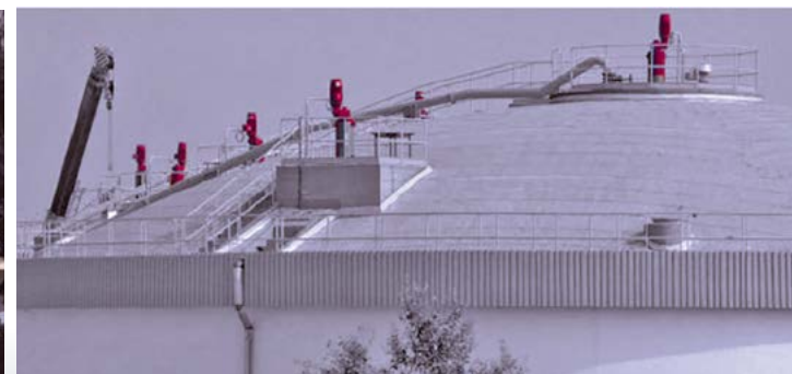
发酵罐（多个搅拌器装置）—— 阿尔及利亚Baraki
